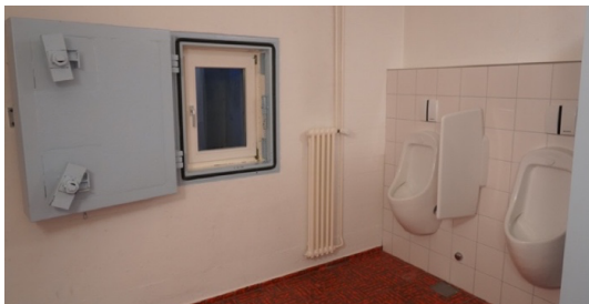
Abbildung 10: WC-Anlage im Luftschutzkeller, mehrfach beanstandet vom Amt für Zivilschutz.
