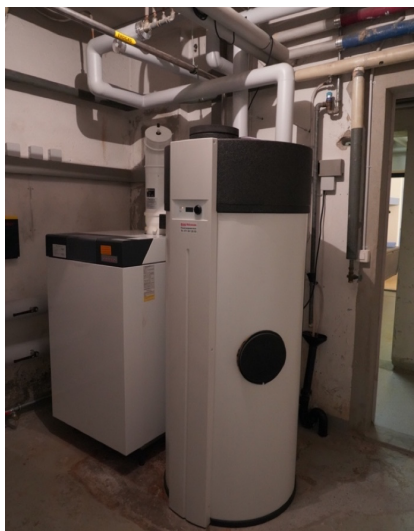
Abbildung 22: Gasheizung – erst wenige Jahre alt.
