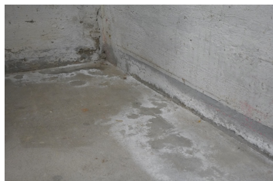
Abbildung 21: Feuchtigkeitsschäden im Keller.
