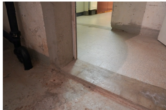
Abbildung 20: Sichtbar gealterte Bausubstanz
