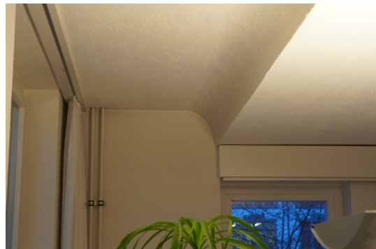
Abbildung 12: Viele unterschiedliche Fussboden- und Deckenhöhen zeugen von den vielen Baueingriffen.
