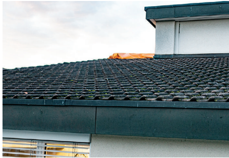
Das Dach ist notdürftig mit Blache abgedeckt
