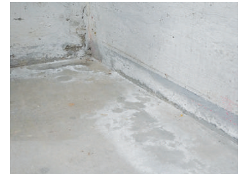
Feuchtigkeitsschäden im Keller
