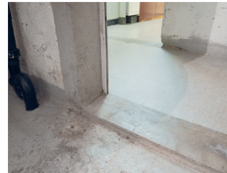
Sichtbar gealterte Bausubstanz
