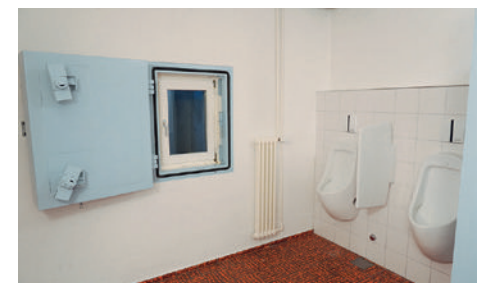
WC-Anlage im Luftschutzkeller
