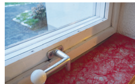
Jahrzehnte alte Fenster
